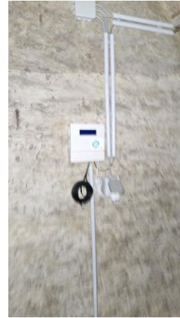
„Kleiner Raum“ – Schaltzentrale (Zweck unklar)
