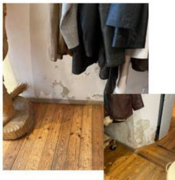
Lederwarengeschäft sind alle Wände feucht
