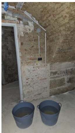
Wasser von Decke
