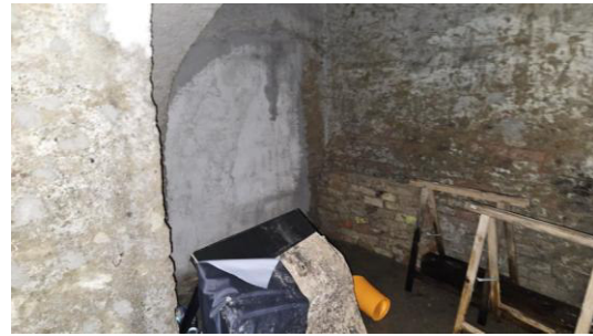
„Großer Raum“- Hinterer Bereich – Nässeeintrag – Hier auch der ehemalige Durchgang zum „kleinen Raum“
