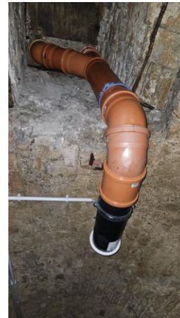
„Kleiner Raum“- Entlüftung unterer Bereich
