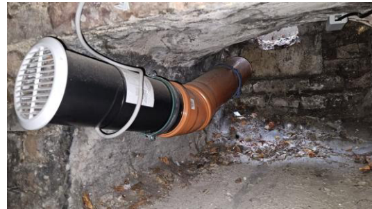
„Kleiner Raum“- Entlüftung Ri Nikolaigasse
